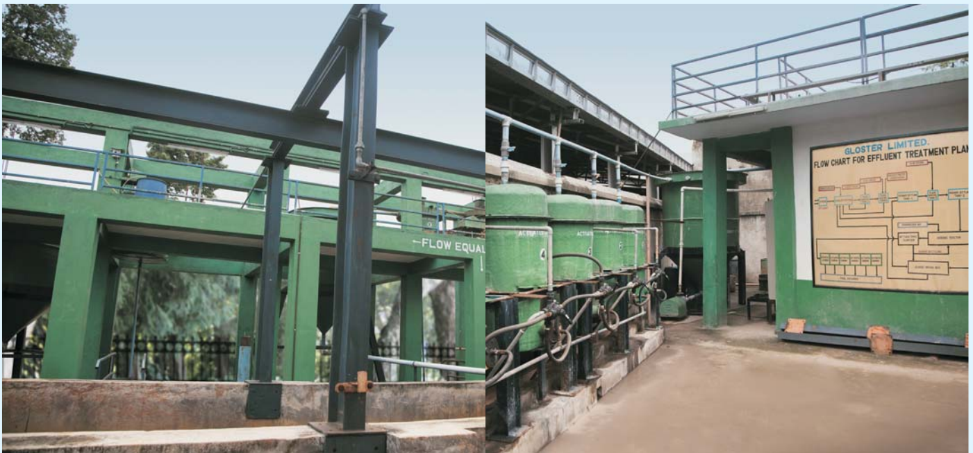
Modern Effluent Treatment Plant (ETP)
