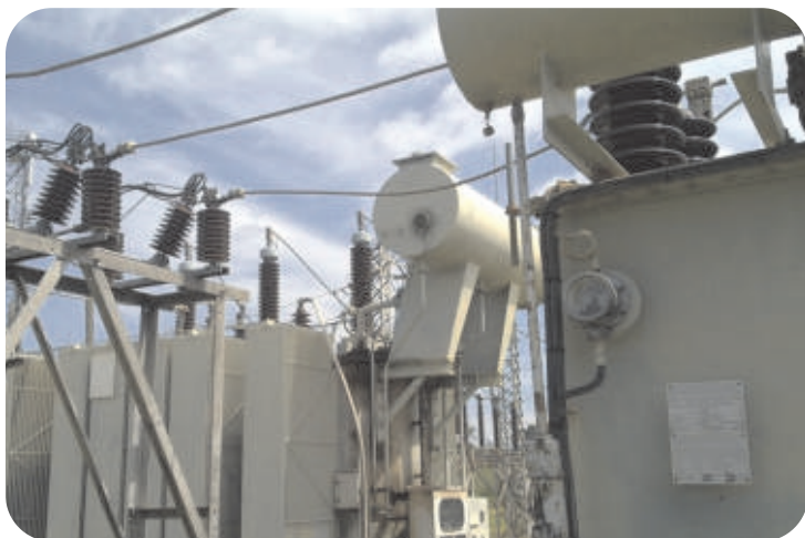
Dan Agundi 132/33kV sub-station
