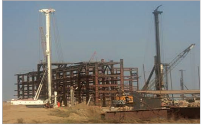
▲ IOCL Refinery Paradip, Orissa.
