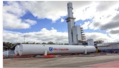
300 KL and 500 KL tanks
