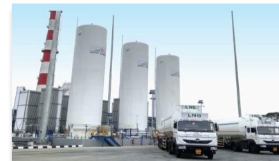
LNG satellite station
