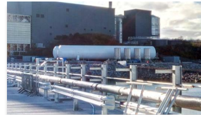
1,000 m 3 Mini LNG Terminal
