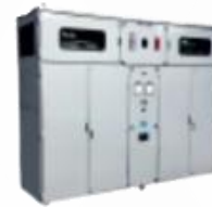
DC Substation Rectifiers
