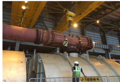
TURBINE AOH, 600 MW UDIPI
