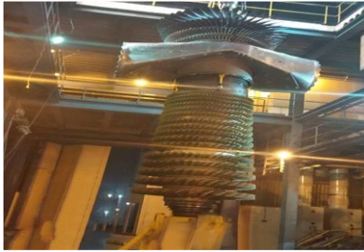
SIEMENS -138MW GAS TURBINE PAGUTHAN
