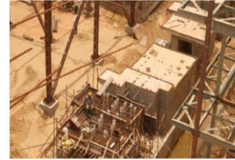
3X660 MW, STPP, STG,BOP ,NORTH KARNAPURA, BHEL
