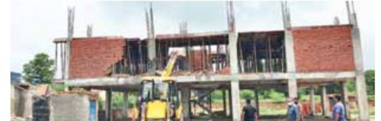
गुरुग्राम के गवालपहाड़ी क्षेत्र में अवैध निर्माण गिराती नगर निगम की जेसीबी।
