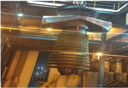
Siemens -138 MW Gas Turbine Paguthan
