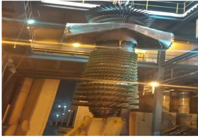
SIEMENS -138MW GAS TURBINE PAGUTHAN
