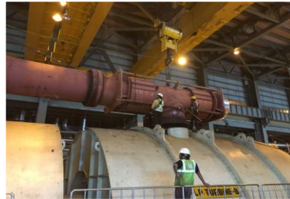
TURBINE AOH, 600 MW UDIPI
