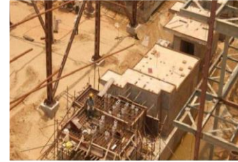
3X660 MW, STPP, STG,BOP ,NORTH KARNAPURA, BHEL
