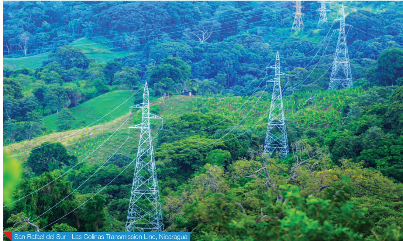
San Rafael del Sur - Las Colinas Transmission Line, Nicaragua
