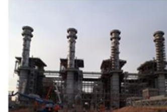
1390MW WAAD AL SHAMALISCCPP, SAUDI ARABIA ETC OF HRSG
