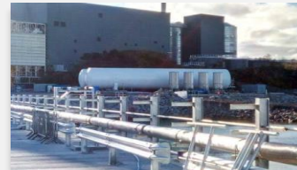
1,000 m 3 Mini LNG Terminal
