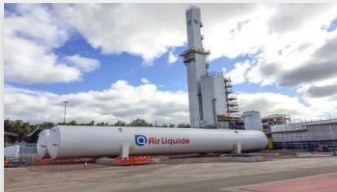
300 KL and 500 KL tanks
