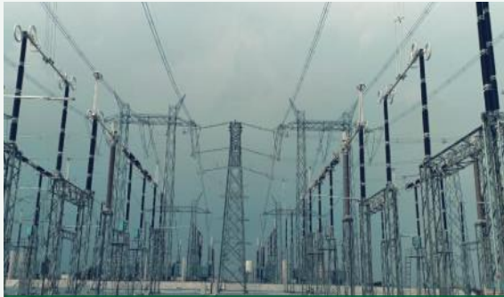
765kV Greenfield AIS/ GIS
