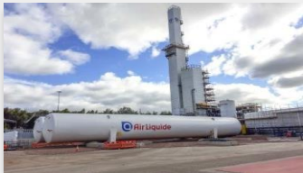
300 KL and 500 KL tanks
