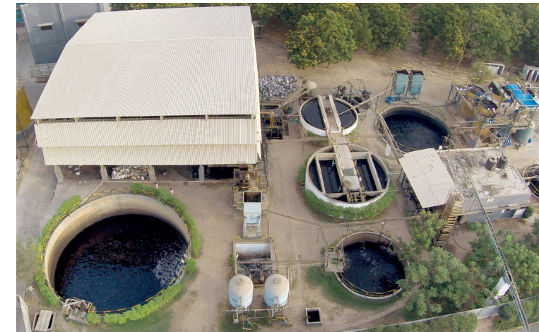
Effluent Treatment Plant (ETP)
