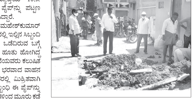
ಮುಖ್ಯಂ ಬೀದಿಯಲ್ಲಿ ಕಾಂಕ್ರೀಟ್ ರಸ್ತೆಗೆ ಅಡ್ಡಲಾಗಿ ಹಾಕಿದ್ದ ನೀರಿನ ಪೈಪ್ ಹಾಗೂ ಇಲ್ಲಿನ ಮನೆಗಳಿಗೆ ವ್ಯಕ್ತವಾಗುತ್ತಿದ್ದ ಕೆಲವು ನೀರಿನ ಪೈಪ್ ಬಳಿದೆಯೇ ಒಡೆದಿತ್ತು. ಹಾಗಾಗಿ ಇಲ್ಲಿ ಕೆಲವು ನೀರು ಬರುತ್ತಿತ್ತು. ಇದನ್ನು ಪತ್ತೆ ಹಚ್ಚಿ ಇಲ್ಲಿಗೆ ಹೊಸ ಪೈಪ್ ನ್ನೇ ಅಳವಡಿಸಲಾಗಿದೆ.
