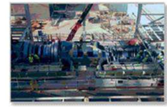
1390MW WAAD AL SHAMALISCCPP, SAUDI ARABIA ETC OF HRSG
