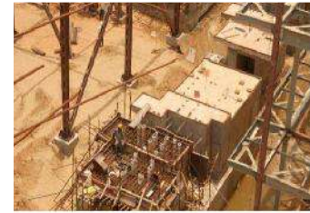
3X660 MW, STPP, STG,BOP ,NORTH KARNAPURA, BHEL
