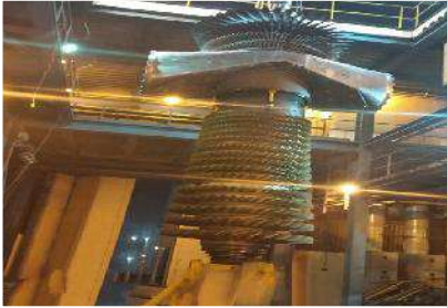
SIEMENS -138MW GAS TURBINE PAGUTHAN
