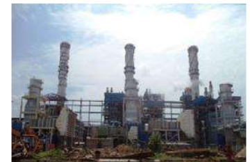
366 MW REFINARY, GTG, STG, HRSG & PIPING, PARADIP, BHEL
