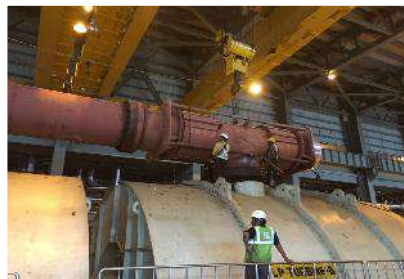
TURBINE AOH, 600 MW UDIPi
